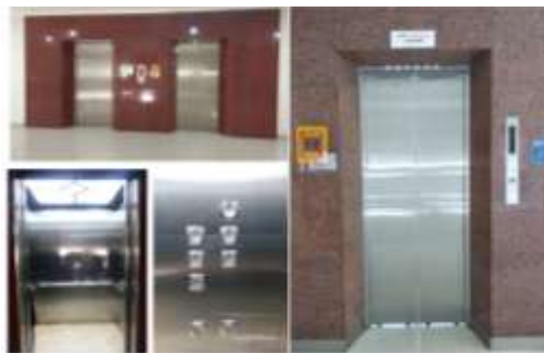
Gambar 5. Kondisi Lift di Kampus Terpadu UNISA
