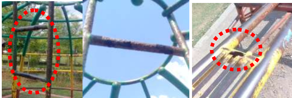
Gambar.5 Material dari besi yang sudah keropos
